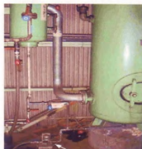
エアータンクとセパレーター 砂糖工場 H3～稼働中
