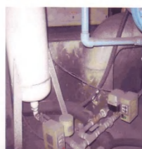
末端のドレンポット 製鐵所 H3～
